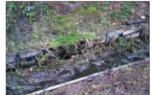
Hier ist die Holz-Kante sowieso zerfallen und kann gar nichts mehr sichern. Sie muss entfernt werden oder falls notwendig, erneuert werden.
