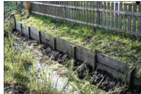
Diese Holz-Kaimauer ist generell nicht zulässig. Bei Ausnahmegenehmigungen darf sie möglicherweise so hoch wie ein Brett sein. Die obere Brettreihe muss also in jedem Falle ab.
