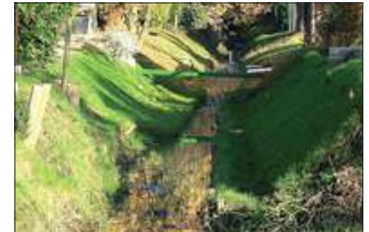
In der Mitte des Bildes ist sehr gut eine Engstelle im Graben sichtbar. Ist hier möglicherweise nicht schlimm, aber woanders sicherlich.
