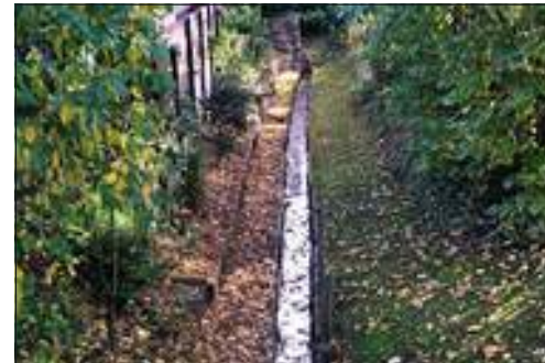
Hier sehen Sie eine Hauptentwässerungsstrecke, durch die andere Gräben das Wasser hindurchpressen müssen.
