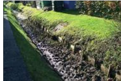
Während fast der gesamte Graben Wasser führt, ist hier eine verschlammte Strecke, die den Wasserfluss behindert.
