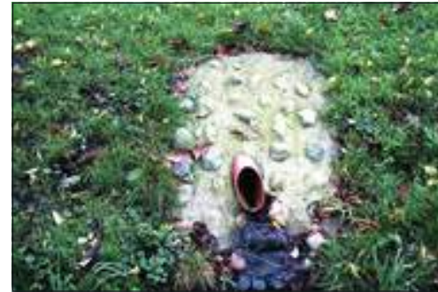
Hier ist das Rohr mit Beton und kleinen Steinen eingefasst. Sehr gut: schräger Rohranschnitt. Es fehlt die Einfassung bis in die Grabensohle.
