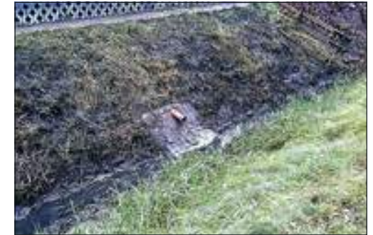
Auch hier eine fast richtige Rohreinfassung. Die Steine gehen bis in die Grabensohle und können so ein Ausspülen verhindern. Bitte noch das Rohr schräg anschneiden.
