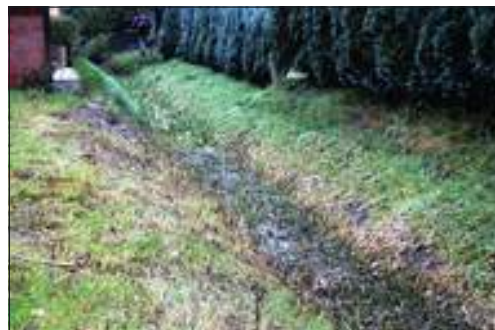
Auch hier ist noch Gras und Bewuchs in der Grabensohle
