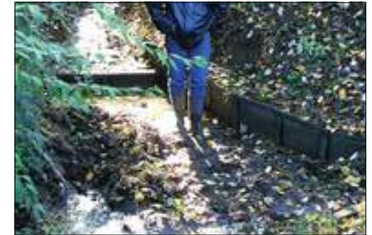
Die Sohle ist zu flach und verschlammte. Bitte wegraben.
